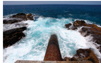
ネルハ取水パイプライン
