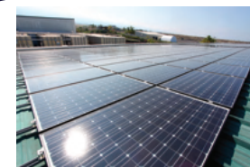
太陽光発電システム
